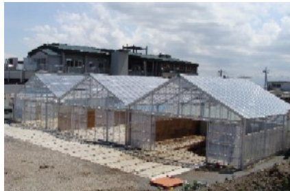
ソーラーハウス設備 3棟 工場の隣接した場所に設置
