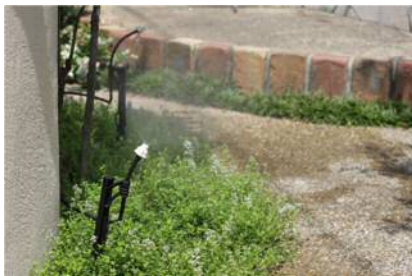
自動散水システム
