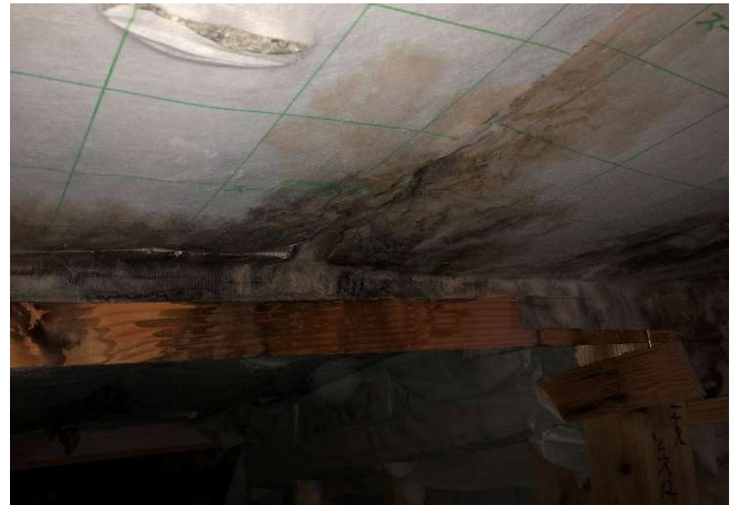
断熱材からの結露水で腐った屋根部分
